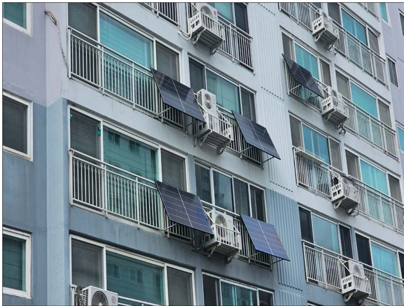
아파트 베란다 태양광 설치 사진
